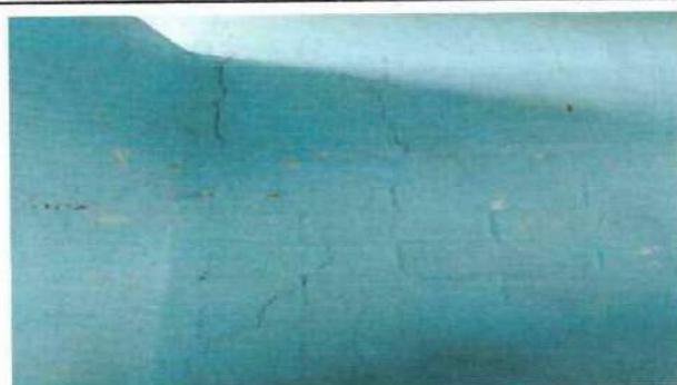
Foto 4: Pared quebrada en las dos aulas
