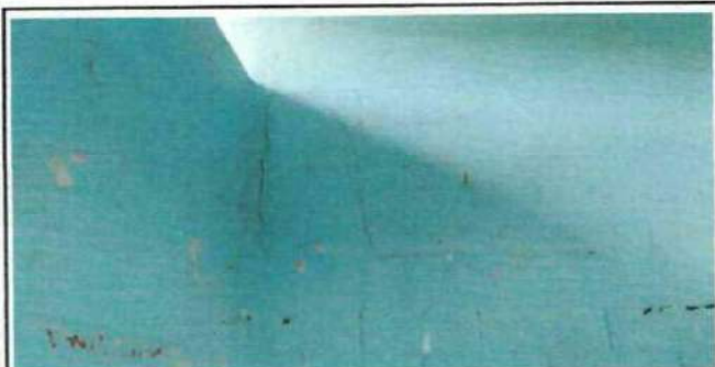
Foto 5: Pared quebrada en la sala
